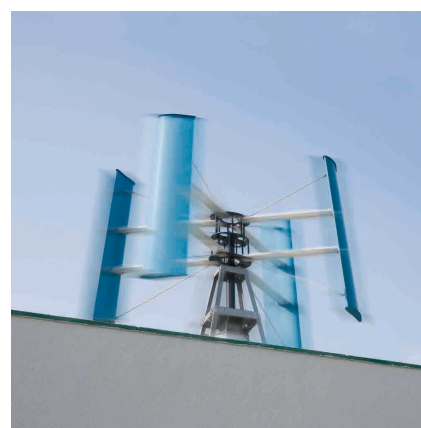
▲ 小形風力発電機
