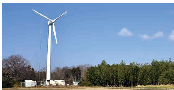
▲ 100kW風力発電装置
