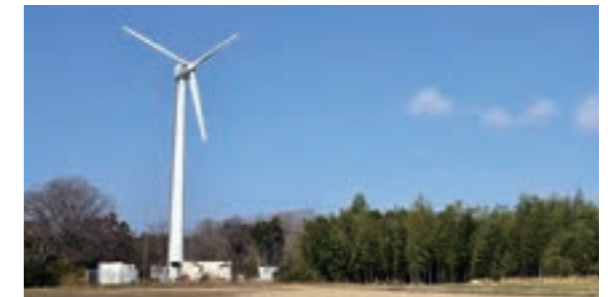
▲ 100kW風力発電装置
